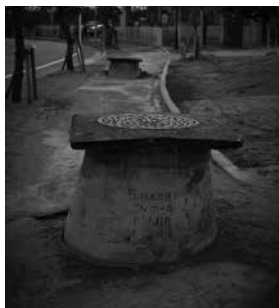
地震により浮き上がったマンホール
